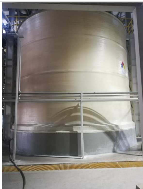
高氯废水絮凝沉淀装置
