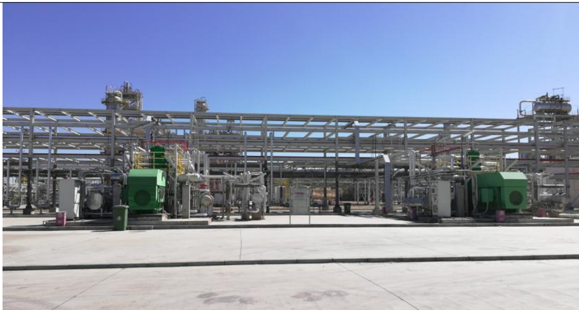
噪声设备区（采用基础减震）
