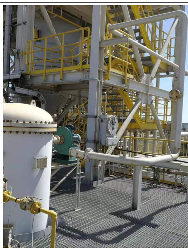
碳酸钙收尘器排气监测口
