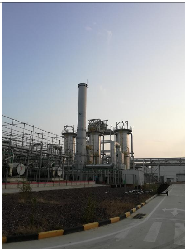
硅烷装置区导热油炉排气筒(3台导热油炉1用2备,公用1个30m高集束排气筒)
