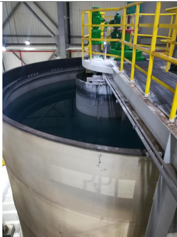
高氯废水处理装置上部
