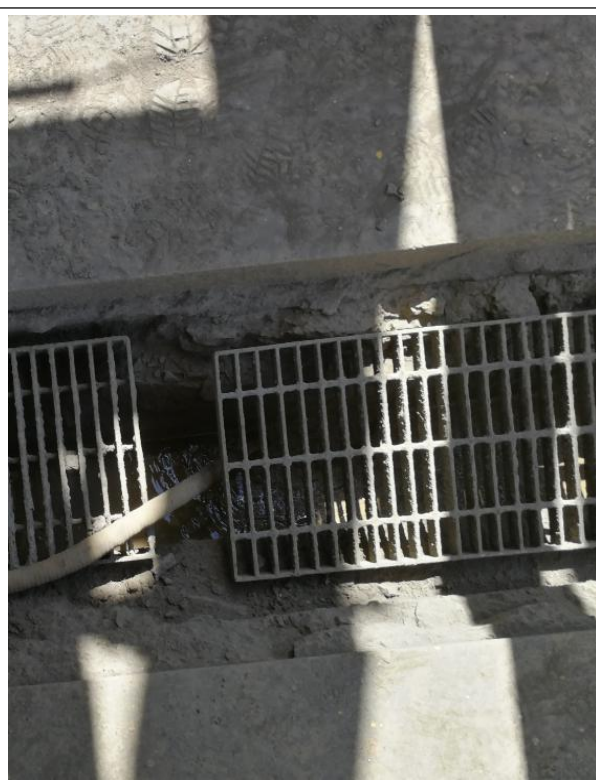
装置区导流槽
