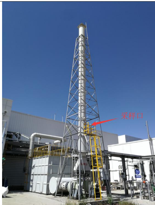
超纯硅车间酸性废气干式吸附装置+排气筒
