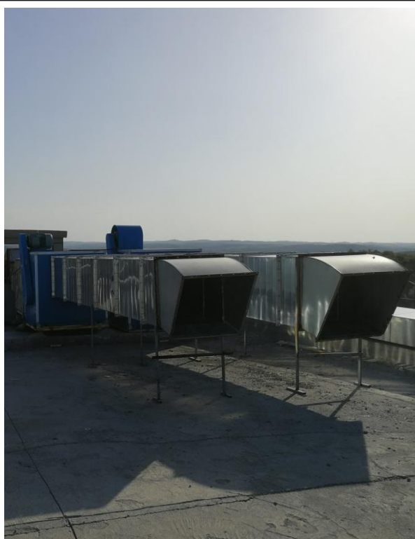
生活区食堂顶部油烟净化装置
