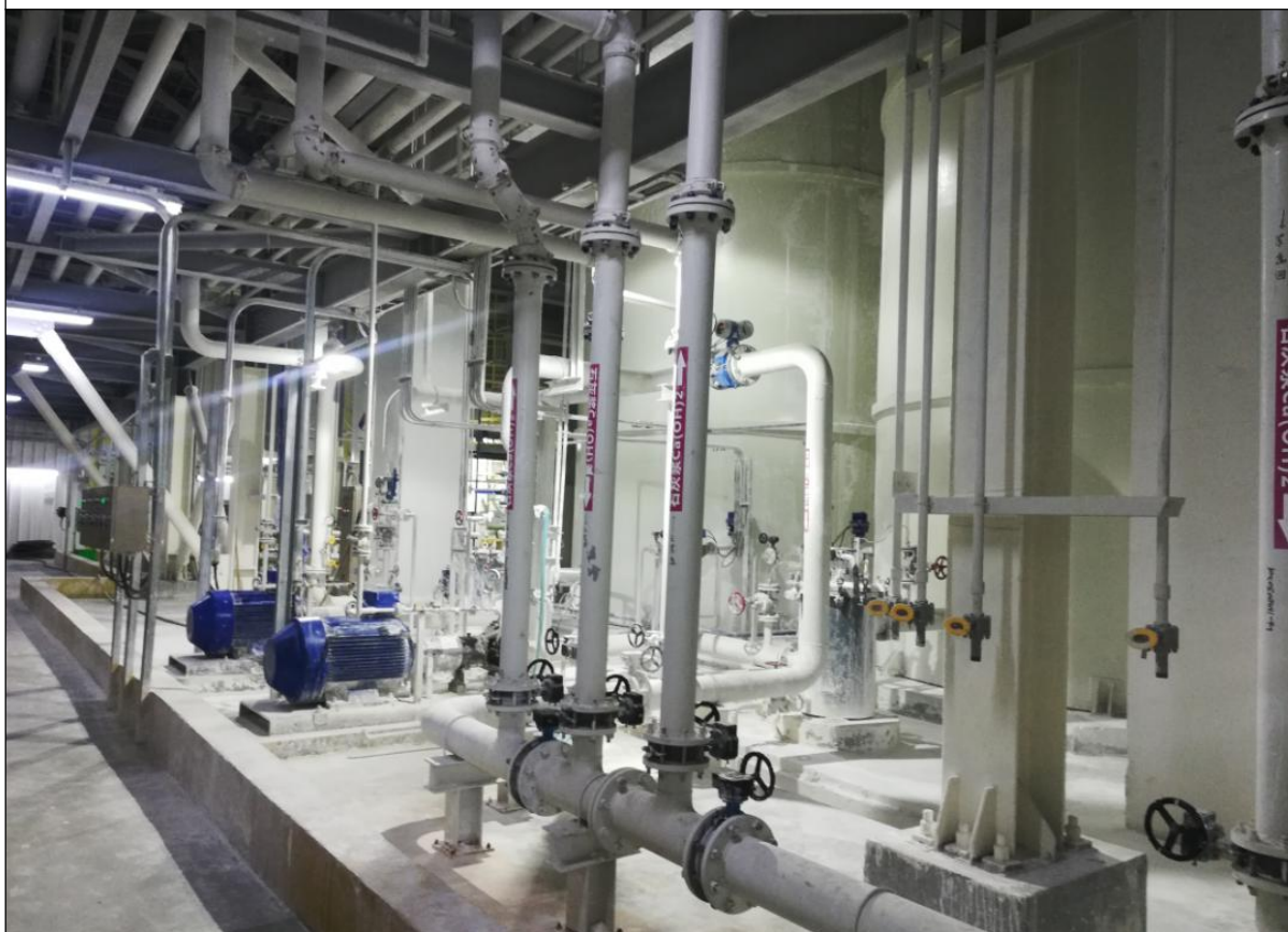
工艺废气处理设施加药系统
