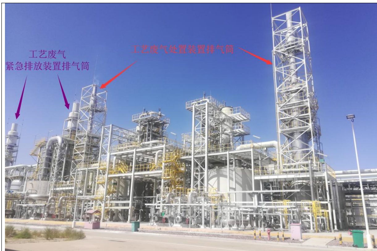
工艺废气处理设施
