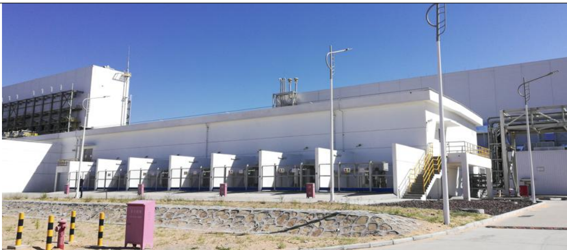
噪声设备区（采用基础减震）
