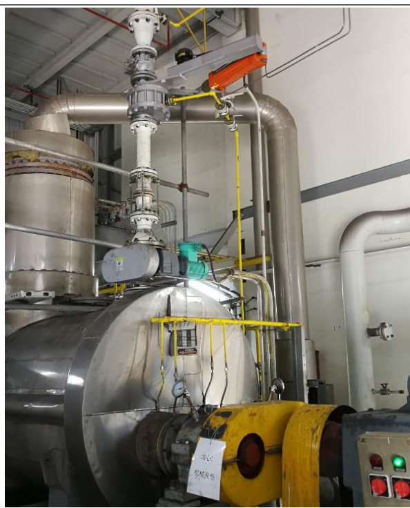
硅粉料仓加料装置除尘设施
